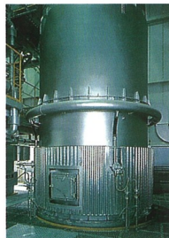
②ガス冷却室
