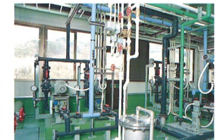
●生物処理設備
