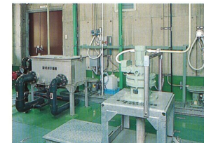
●カルシウム除去設備
