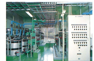
●薬品注入設備
