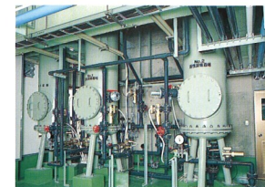
●高度処理設備
