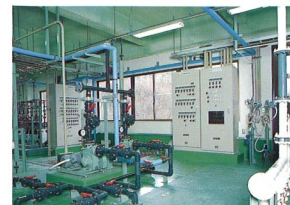
●凝集沈殿処理設備
