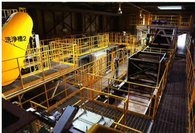
焼却灰水洗装置（SMASHシステム）
