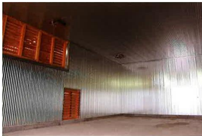
雪を利用した夏期空調・保冷設備（雪室）
