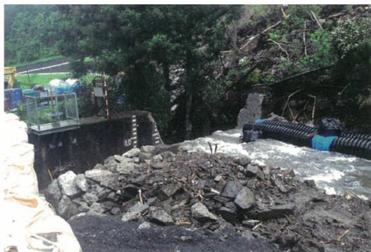
写真－2.3.3 県道西大山大野日田線斜面崩壊現場の砂防堰堤袖部 4)
