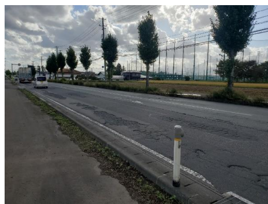
ひび割れ状況
