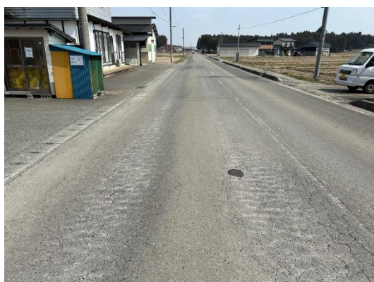
わだち掘れ状況
