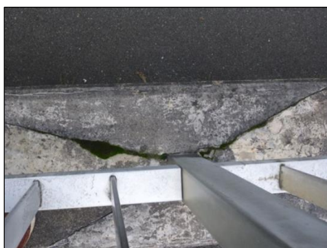
擁壁工 天端コンクリートの割れ
