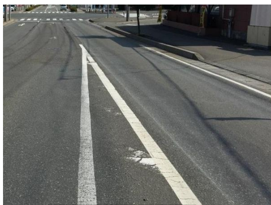
わだち掘れ状況
