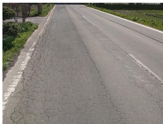
ひび掘れ状況
