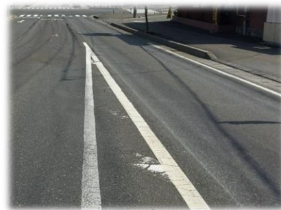
わだち掘れ状況
