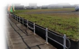
防護柵 施設破損状況
