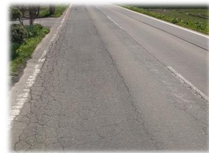
ひび割れ状況
