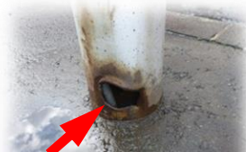
道路照明 支柱の破断
