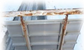
標識(案内板)錆発生状況
