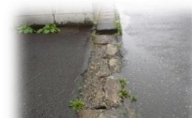
道路側溝 施設破損状況
