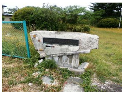
修繕前の公園の門柱
