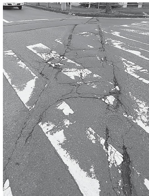
道路のひび割れ状況
