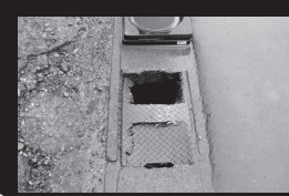
道路側溝の破損
