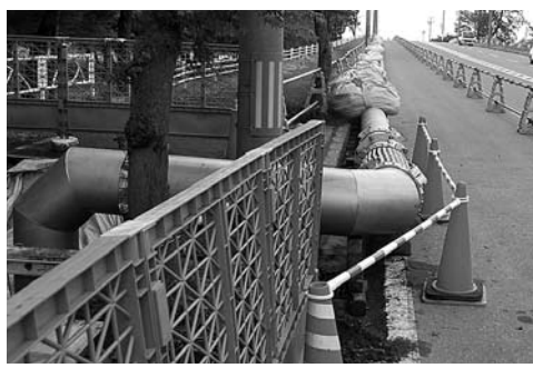
飯豊こ線橋上に仮設された水道管。漏水部分を切断し、地下から地上を通して配水しています
