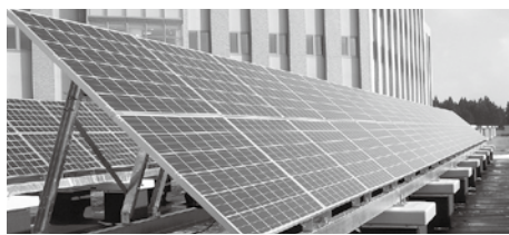
太陽光発電設備 (当社施工・市内病院)
