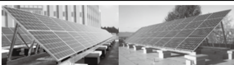
太陽光発電設備 (当社施工・岩手中部病院)
