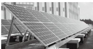
太陽発電設備 (当社施工・岩手中部病院)
