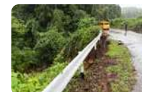
道路のり面崩落(和賀町煤孫)
